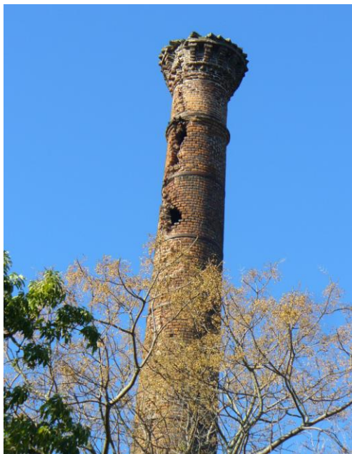
Figura 51 Deterioro del fuste 51
